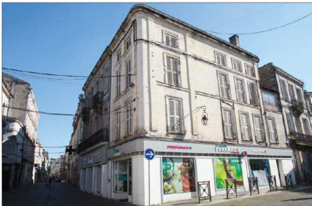
Le taux de vacance atteint 15 % dans le centre-ville. Au-dessus des commerces, les logements ont besoin d'un gros coup de rénovation.
