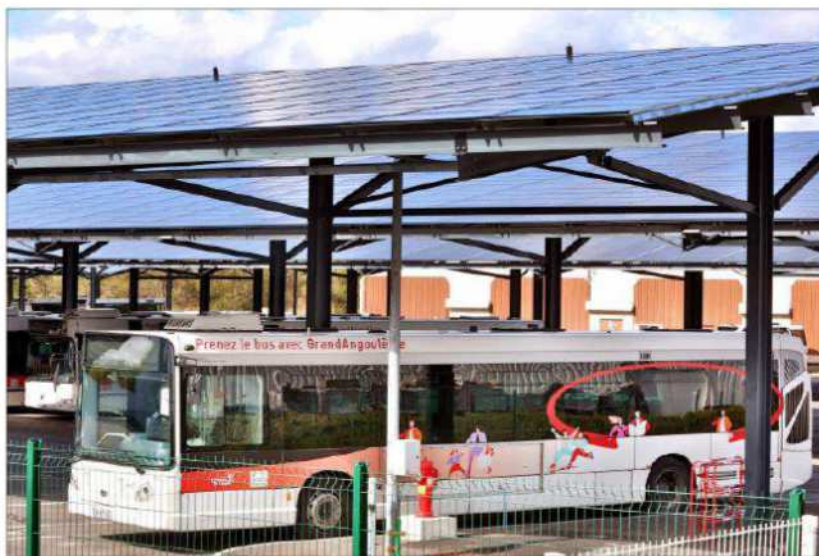
Les neuf ombrières de la STGA ont été en partie financées par les plateformes Lumo et Lendopolis. Au total, 180 000 euros ont été collectés.
