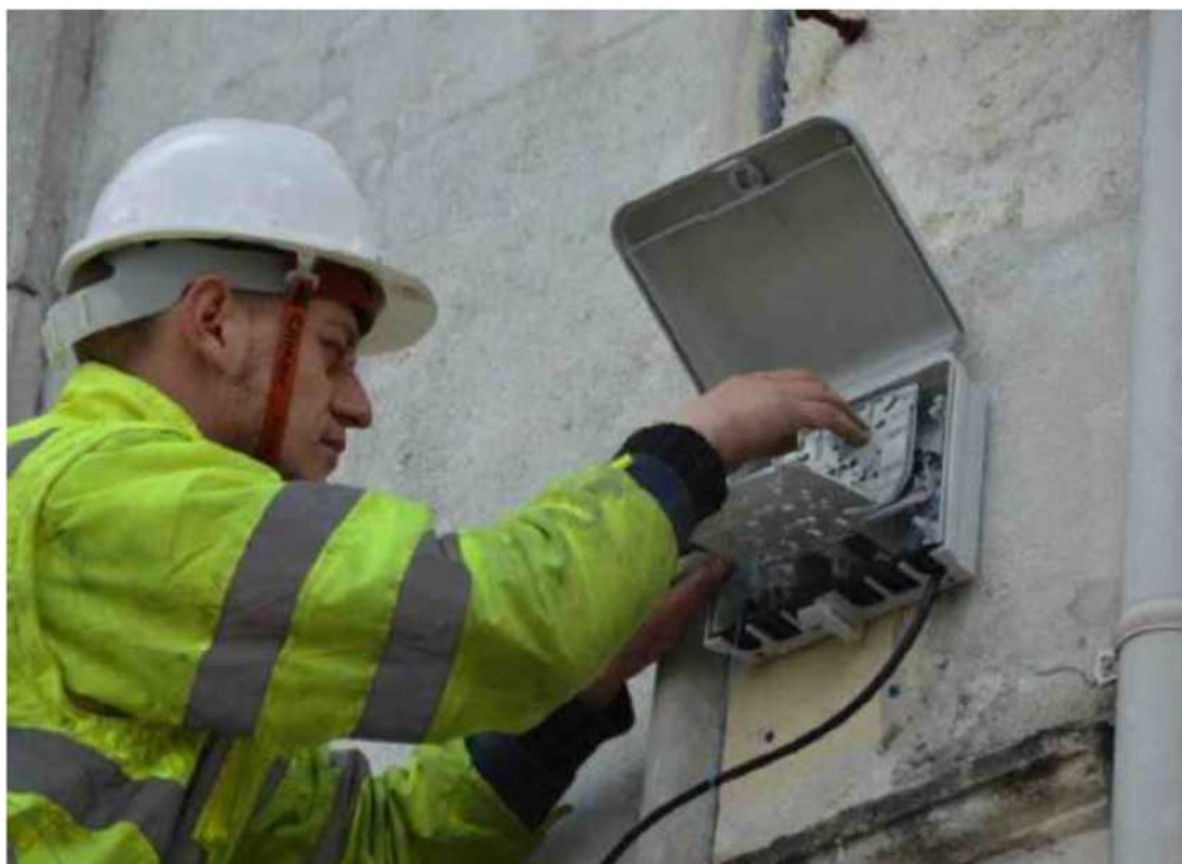
D'ores et déjà, 5 450 logements sont éligibles à la fibre. C'est la moitié des foyers que compte la ville. Le reste devrait être fait d'ici 2022. PHOTO ARCHIVES PHILIPPE MÉNARD
