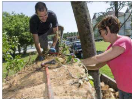
Les habitants enlèvent le lierre sur un vieux mur avant d'envisager la démolition de la partie dangereuse qui passe en contrebas.
