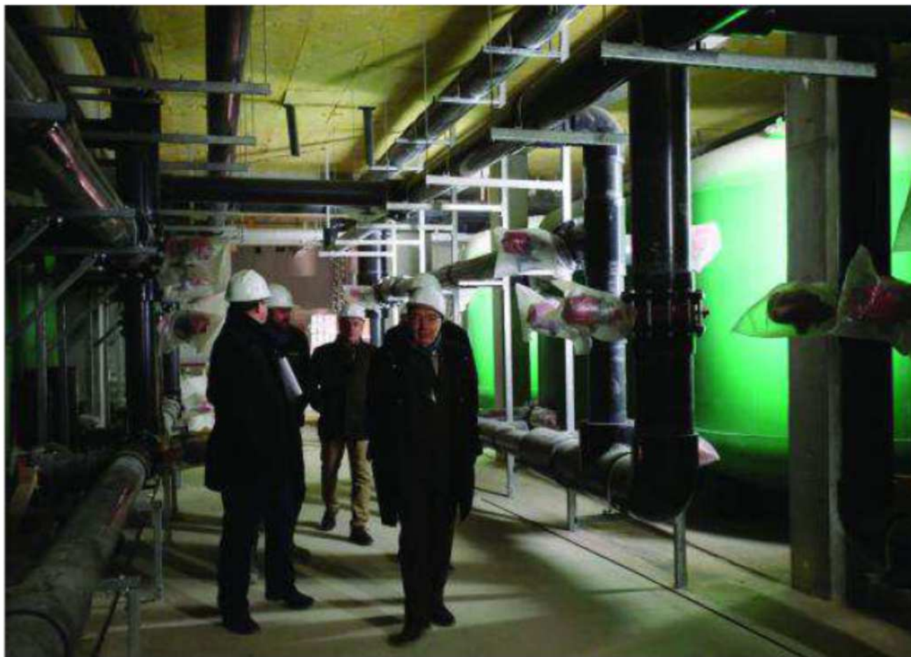
Au sous-sol, les locaux techniques qui abritent les filtres qui serviront à traiter l'eau à l'ozone.
