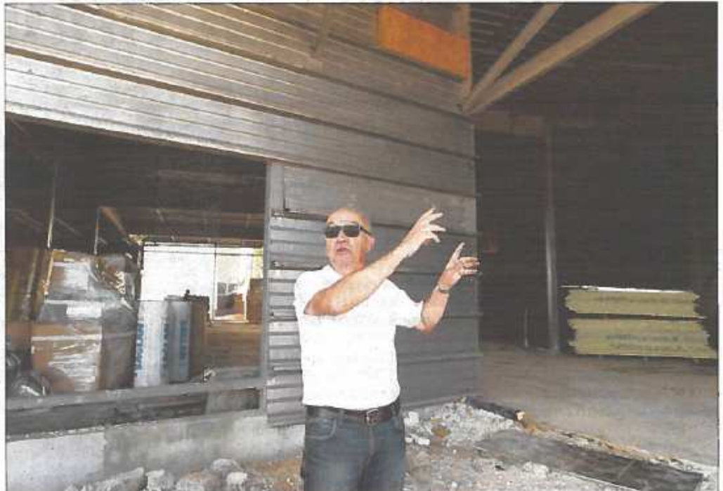
Guy Delage devant la future entrée du multiplexe, un bâtiment de plain-plein de 3 500 m 2 .
