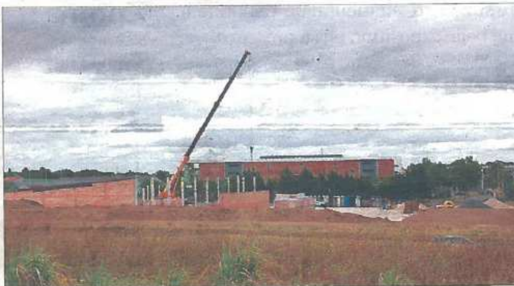
Les travaux du futur Lidl avancent très vite sur ce terrain face à l'hôpital.
