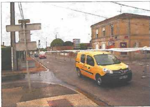
Des textiles vont être déployés sur les grilles pour protéger des poussières.
