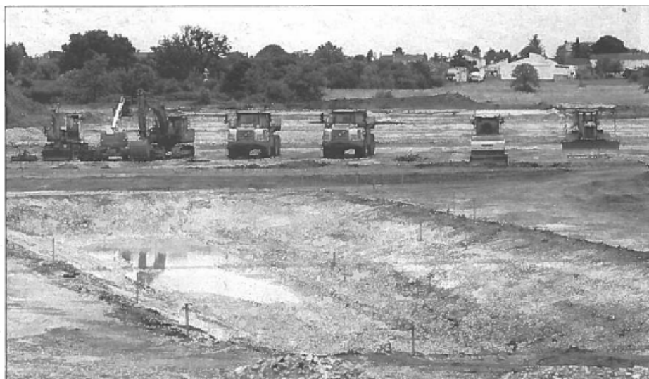
Les pelleuses ont avalé deux terrains de foot et les pluies ont créé une piscine artificielle. Deux ans de travaux sont prévus.
