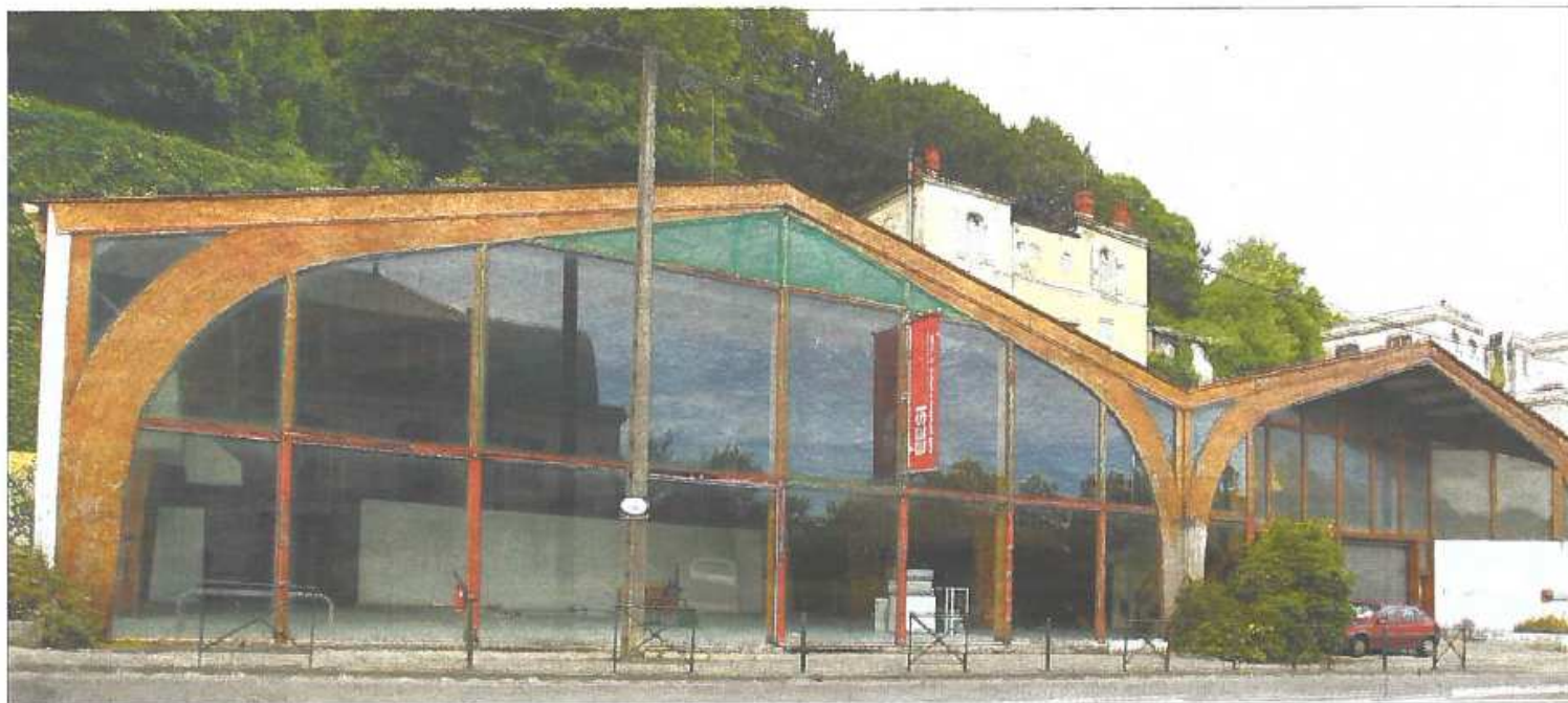
La charpente en bois, caractéristique de la Halle aux Arts, rue de Bordeaux, est trop dégradée. Le bâtiment est définitivement fermé depuis quelques jours.
