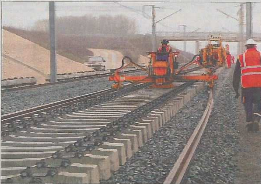
Juillé, hier après-midi. Des engins ferroviaires assurent la pose des traverses et des rails.
