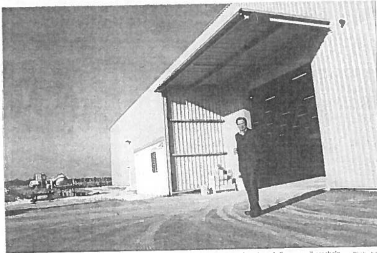
Laurent Charvin suit de près l'évolution du chantier à Merpins. Le déménagement devrait avoir lieu en avril prochain. Photo J. K.
