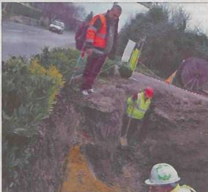
Le câble situé sur la portion de la rue de la Doue en partant de la rue Fernand-Gulonnet jusqu'à la rue des Groies subira juste une section afin de le joindre au nouveau câble posé. PHOTO SANDRA BAUMANN
