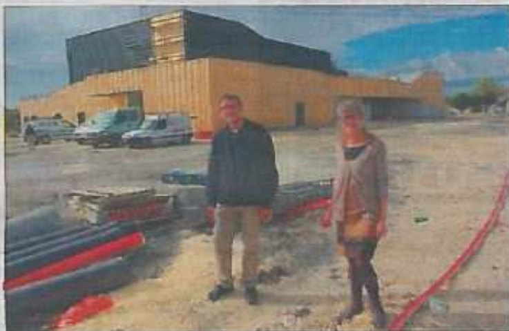
Dominique Petit et Pierre-Yves Briand inaugureront officiellement Le Castel (ici lors des travaux) le vendredi 16 janvier.
