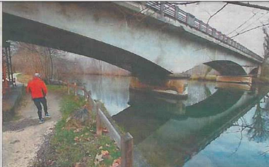
Les promeneurs se font souvent des frayeurs en passant sous le pont posé sur des étais et soutenu par des tirants. Photo Chris Barraud
